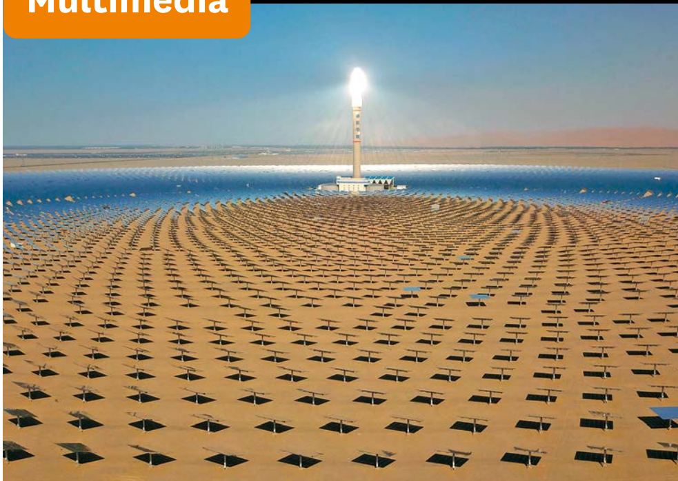
Solarwärmekraftwerk, Dunhuang (China): Energie aus Solaranlagen nimmt exponentiell zu
